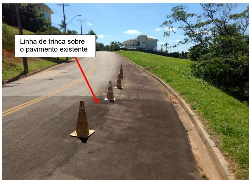
Figura 7 – Fotografia da trinca sobre o pavimento existente.
