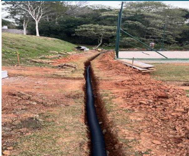
Drenagem da área de lazer
