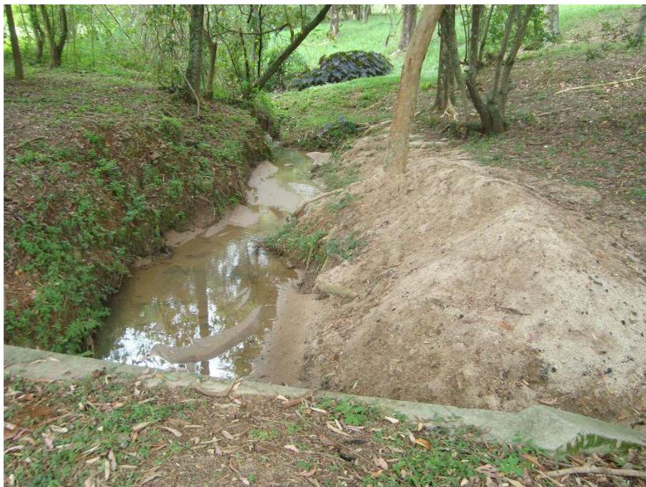
Figura 1 – Trecho final do córrego na chegada ao bueiro/escada hidráulica, em local de deposição de areia.
